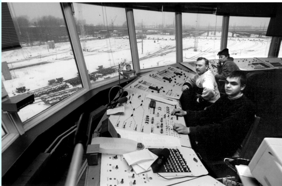
Рис. 2.24. Пост управления автоматизированной сортировочной горкой
